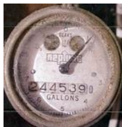
Compteur en gallons d'eau
